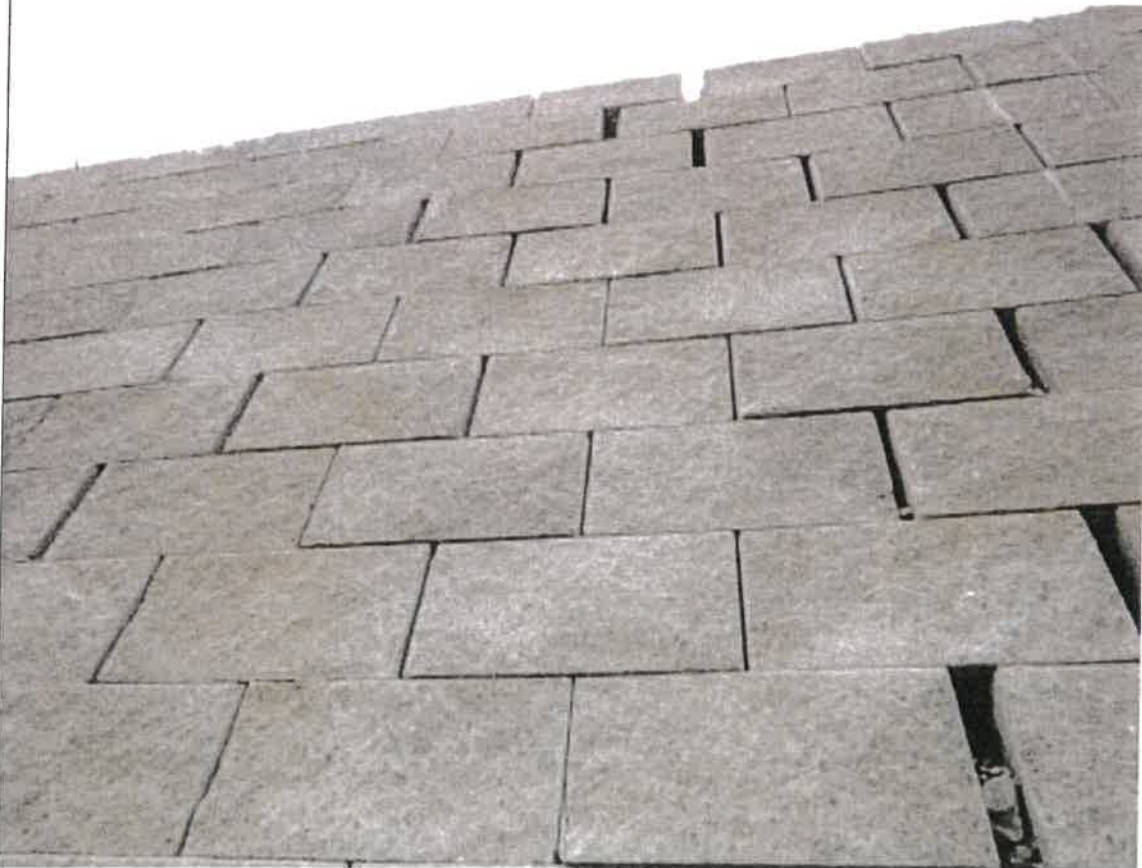
przemieszczenia muru oporowego
