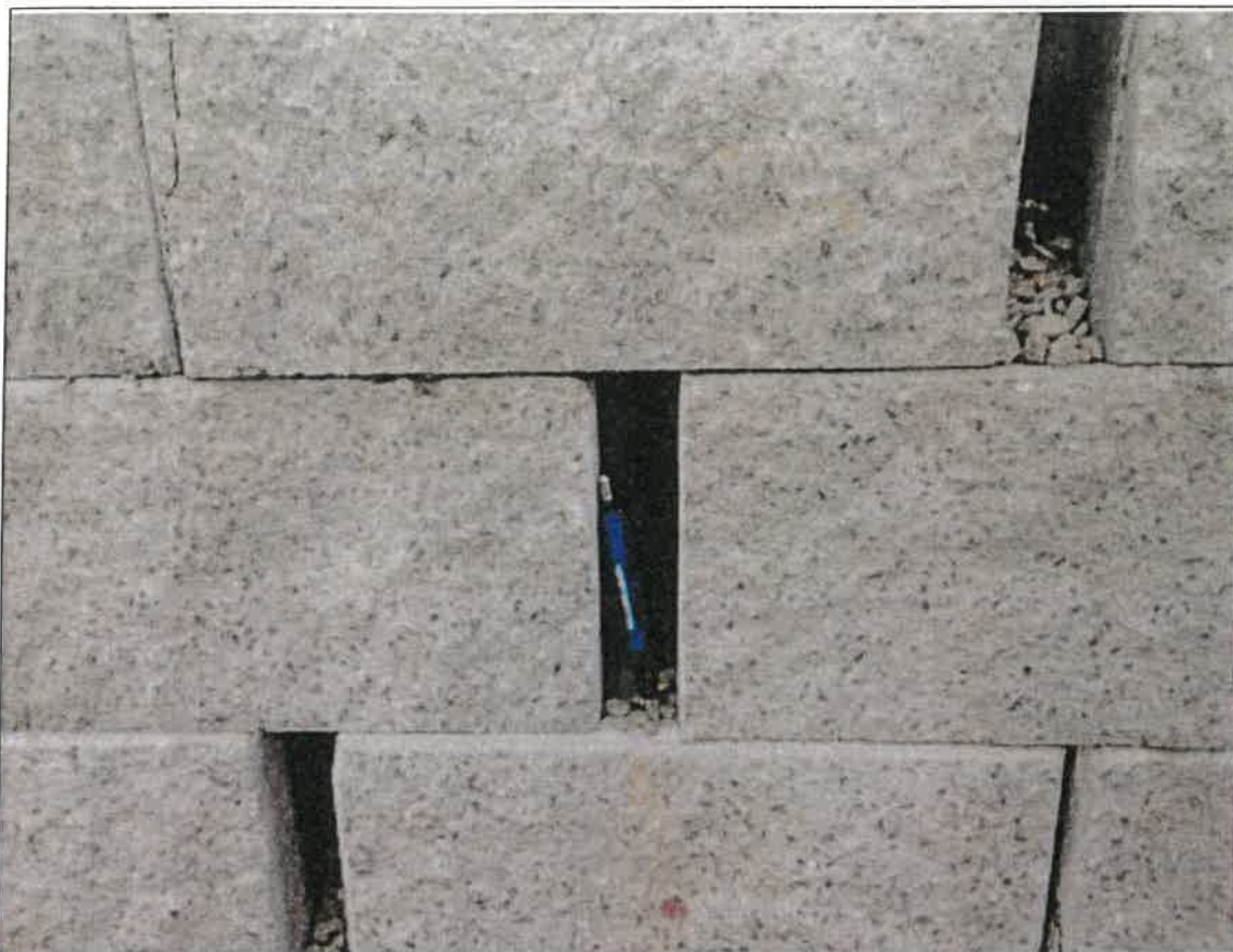
przemieszczenia muru oporowego
