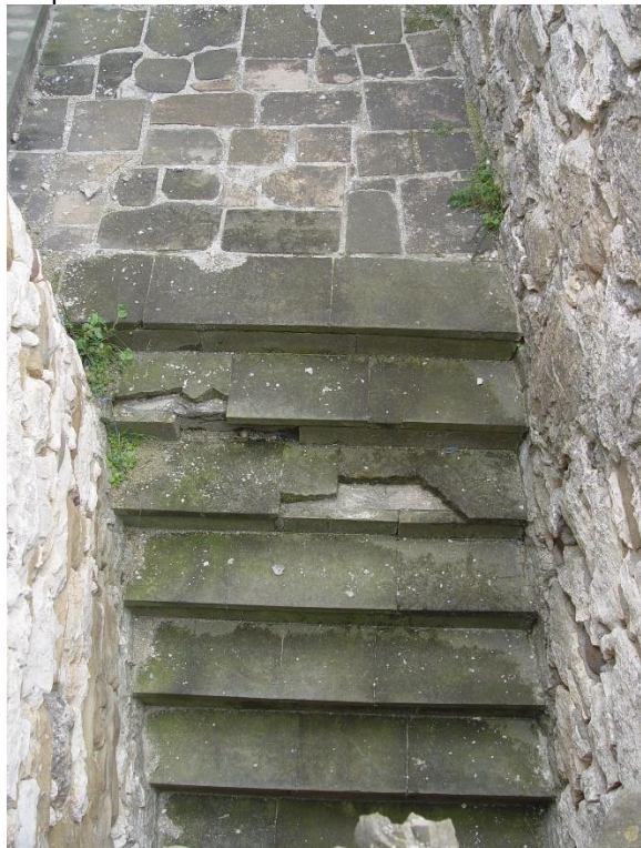
Poškodený pieskovcový obklad kamenných stupňov a podesta schodiska s kamennou dlažbou
