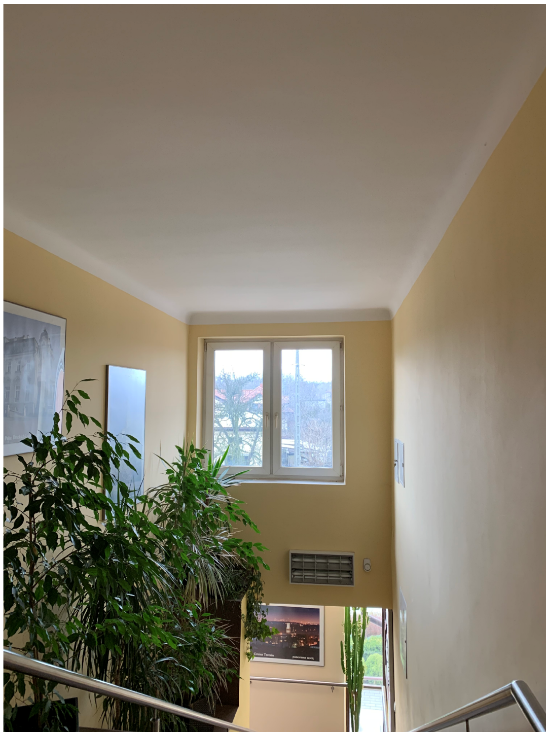
widok z korytarza 1 piętra na ścianę zewnętrzną od strony ulicy Zielonej (widoczna barierka schodów prowadzących z parteru na 1 piętro)
