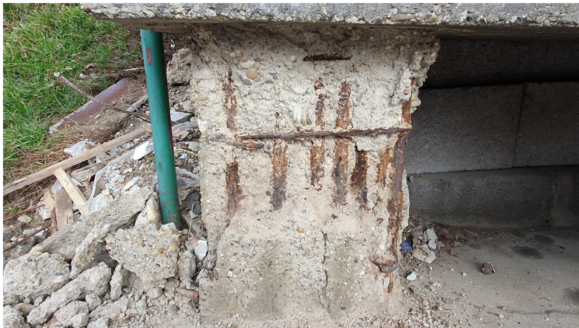
Foto č.16 – solením vážne poškodená päta stĺpa S1
