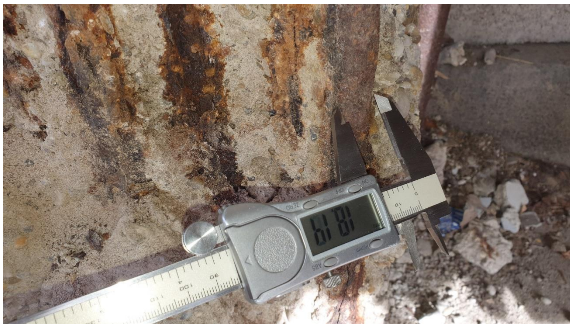
Foto č.17 – solením vážne poškodená päta stĺpa S1 – detail aktívneho korózneho stavu výstuže
