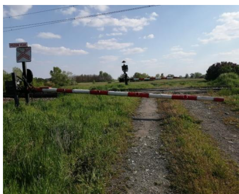
Obr.č.3 Závorový stojan B km 19,0315
