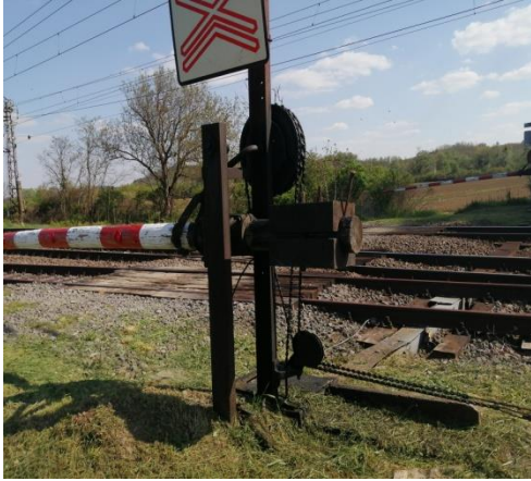
Obr.č.7 Závorový stojan B km 28,536
