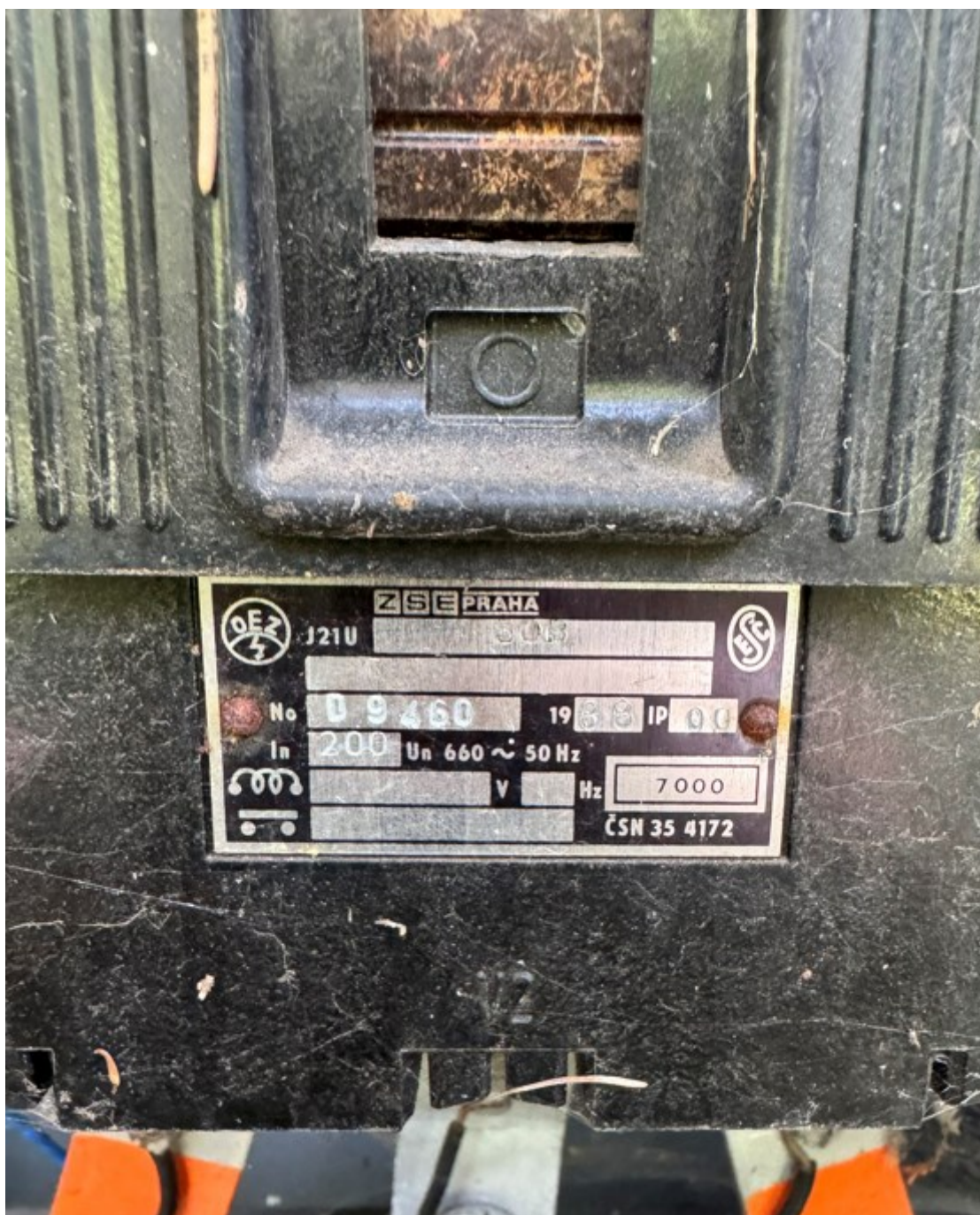
Fotografia č. 3 Prípojka hlavného ističa pred elektromerom
