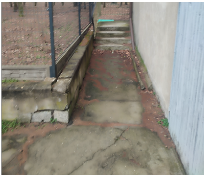
Fotografia 14 Schody i murek od strony zachodniej przeznaczone do remontu – dojście z betonu przeznaczona do rozbiórki
