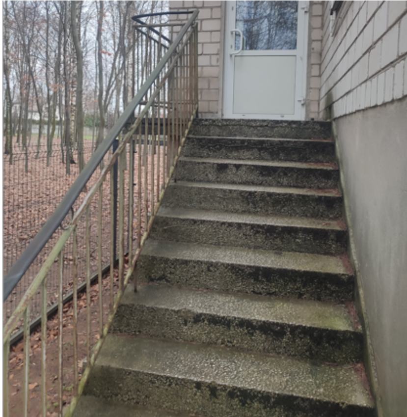
Fotografia 9 Schody na końcu budynku do części mieszkalnej od strony zachodniej przeznaczone do remontu
