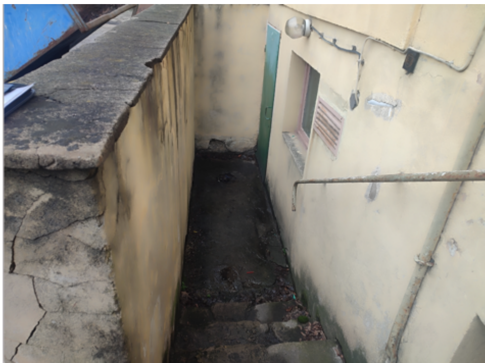
Fotografia 10 Schody do kotłowni od strony zachodniej przeznaczone do remontu
