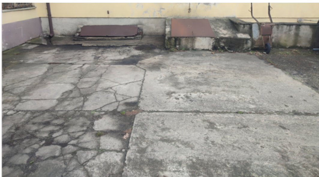
Fotografia 12 Betonowy plac oraz zsypy do piwnic od strony zachodniej przeznaczony do rozbiórki
