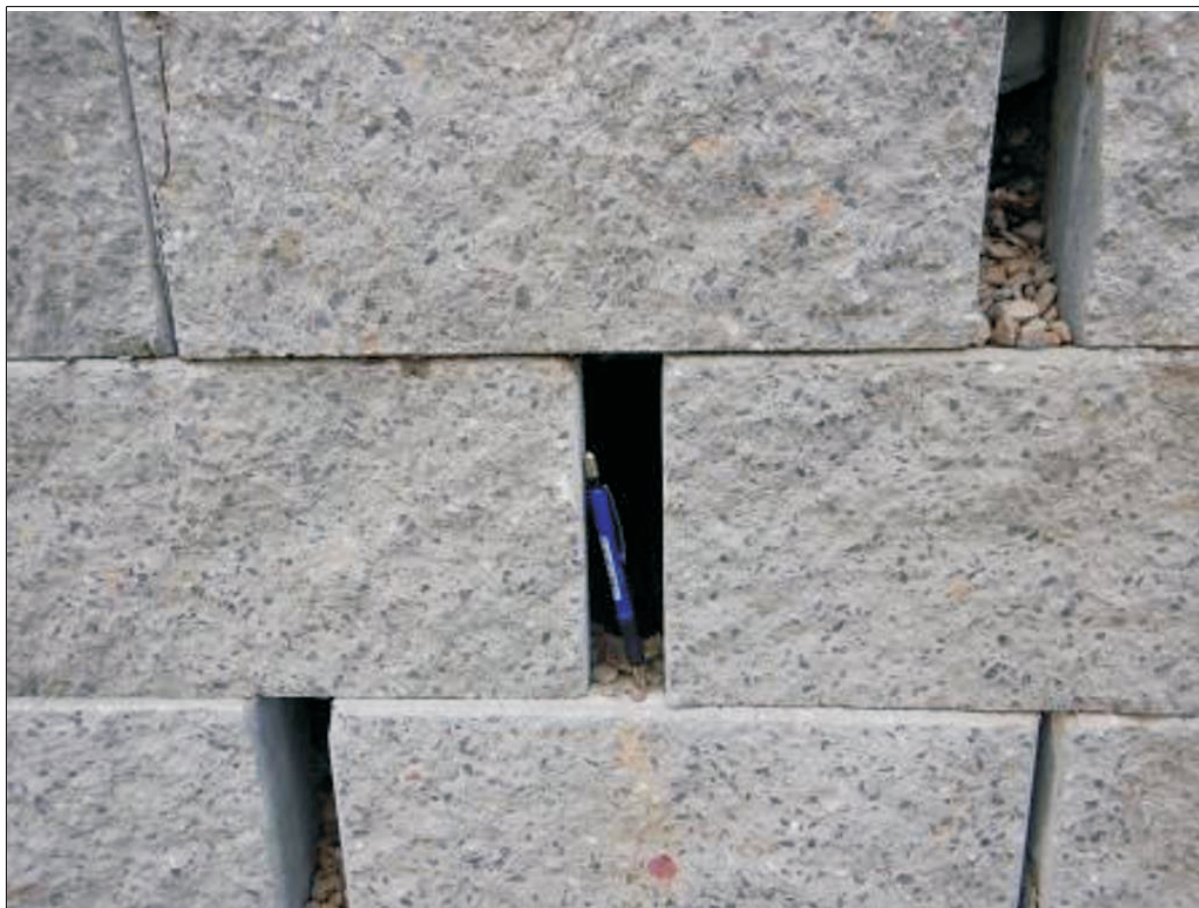
przemieszczenia muru oporowego
