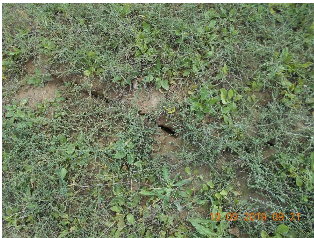
Fotogram nr 13 pęknięcie na granicy gruntu zbrojonego muru oporowego 1- część wysunięta najbardziej na wschód
