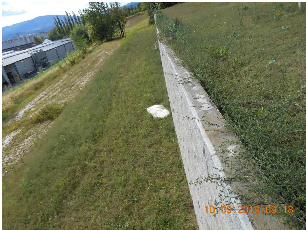
Fotogram nr 12 odkształcenie muru oporowego 1- część wysunięta najbardziej na wschód
