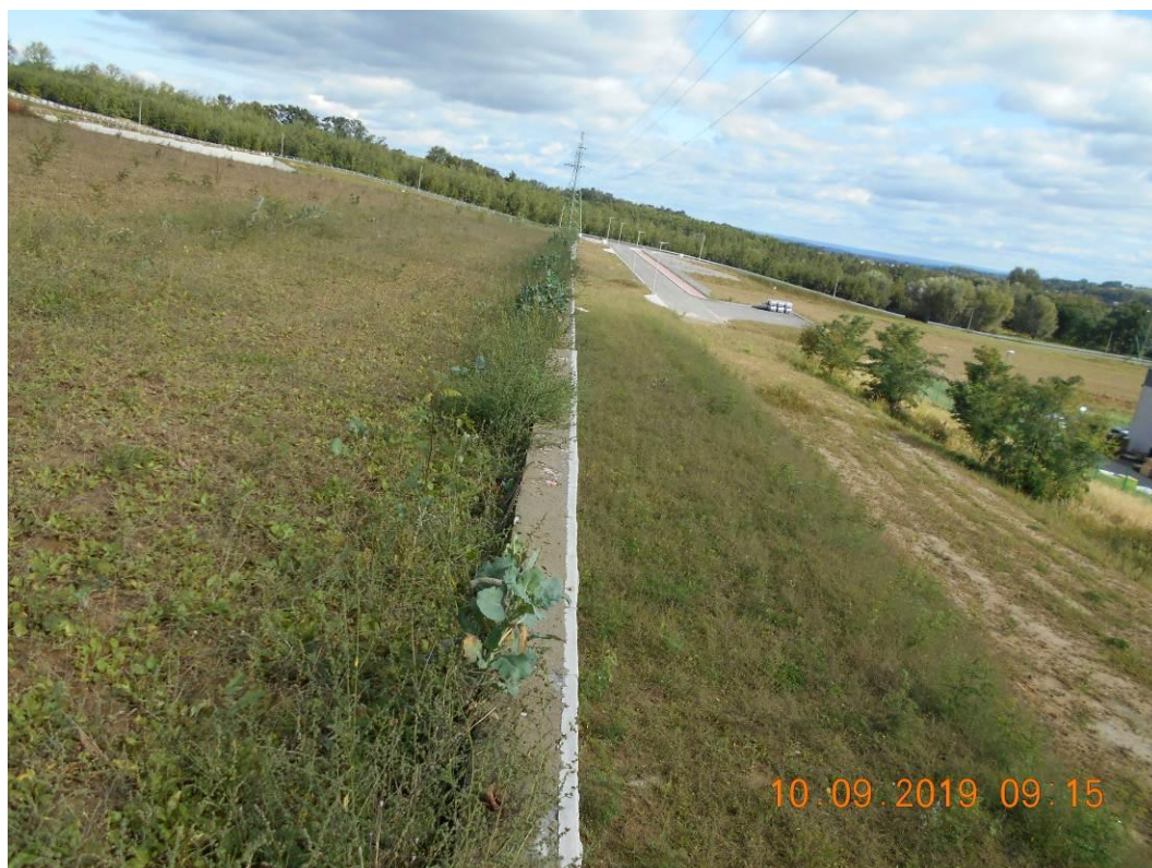
Fotogram nr 17 odkształcenie muru oporowego 1- część wysunięta najbardziej na wschód
