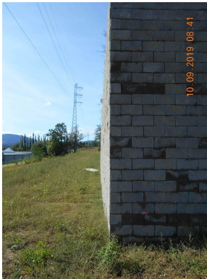
Fotogram nr 16 odkształcenie muru oporowego 1- część wysunięta najbardziej na wschód
