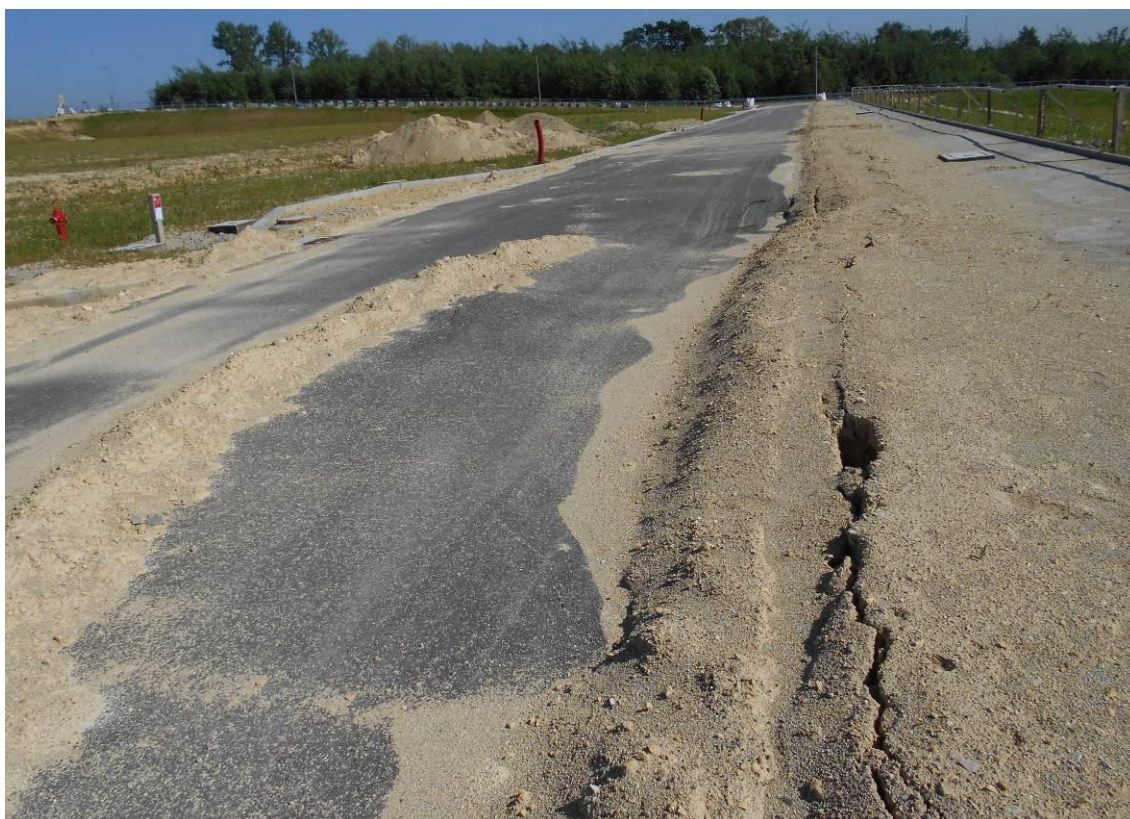
FOTOGRAM 5 – widok zasypanego chodnika, który uległ deformacją w wyniku osiadania terenu
