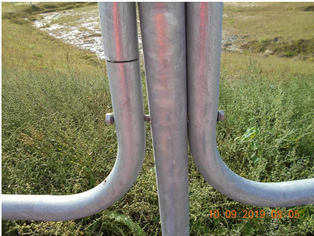
Fotogram nr 30- widoczny luz pod podkładkami łączącymi poszczególne pręśła balustrady.
