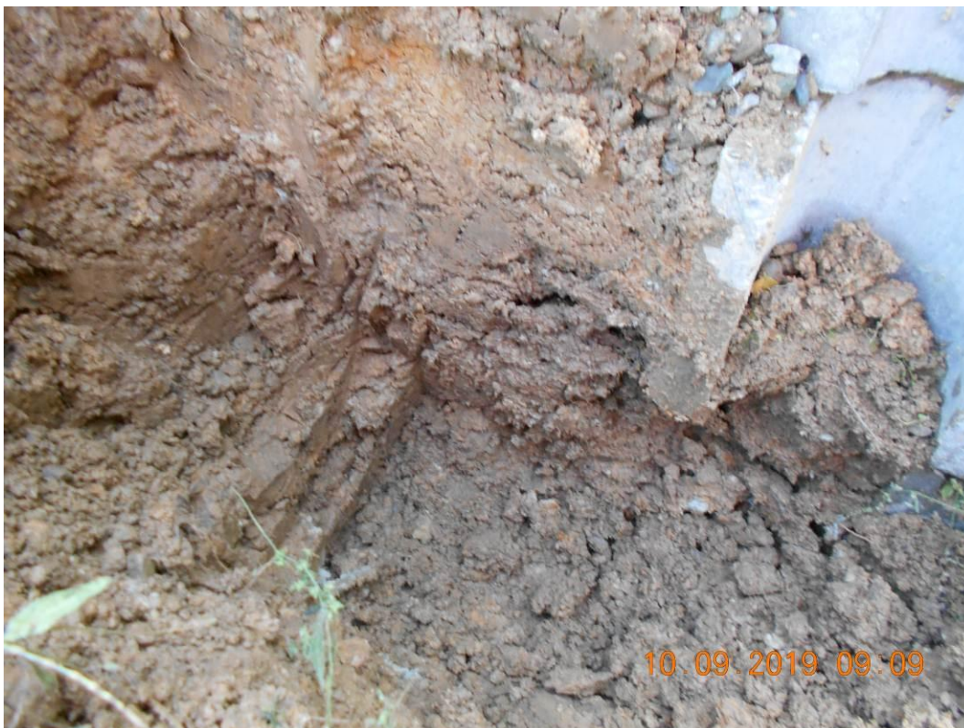
Fotogram nr 3 grunt spoisty w miejscu gdzie miała być wykonana zasypka filtracyjna, mur oporowy 1
