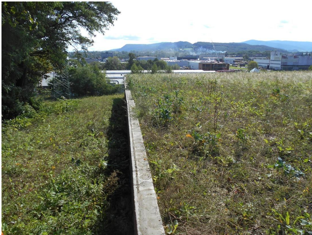
Fotogram nr 42 mur oporowy nr 2- widoczna deformacja
