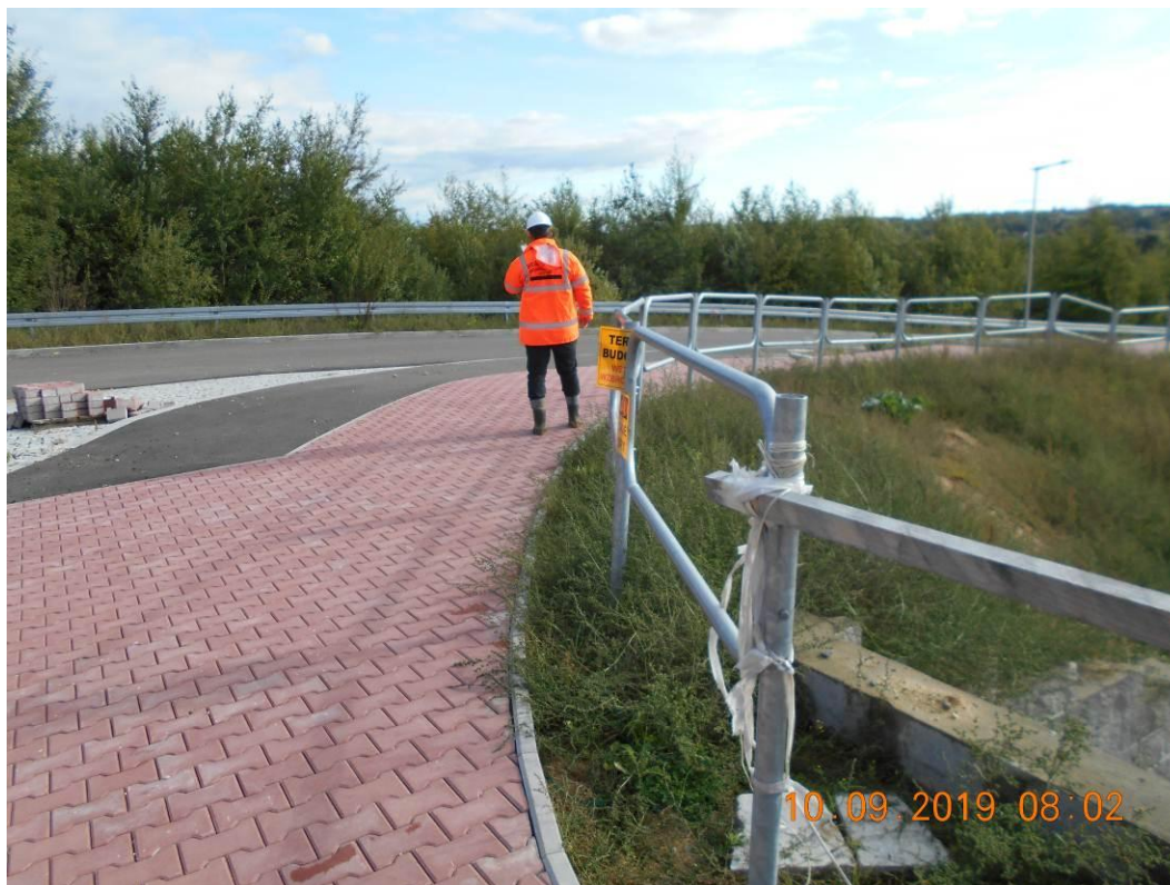
Fotogram nr 29 Mur oporowy 1, część wysunięta najbardziej na północny-zachód, widoczne przemieszczenia balustrady w dół zbocza oraz w dół wykonanego nasypu.
