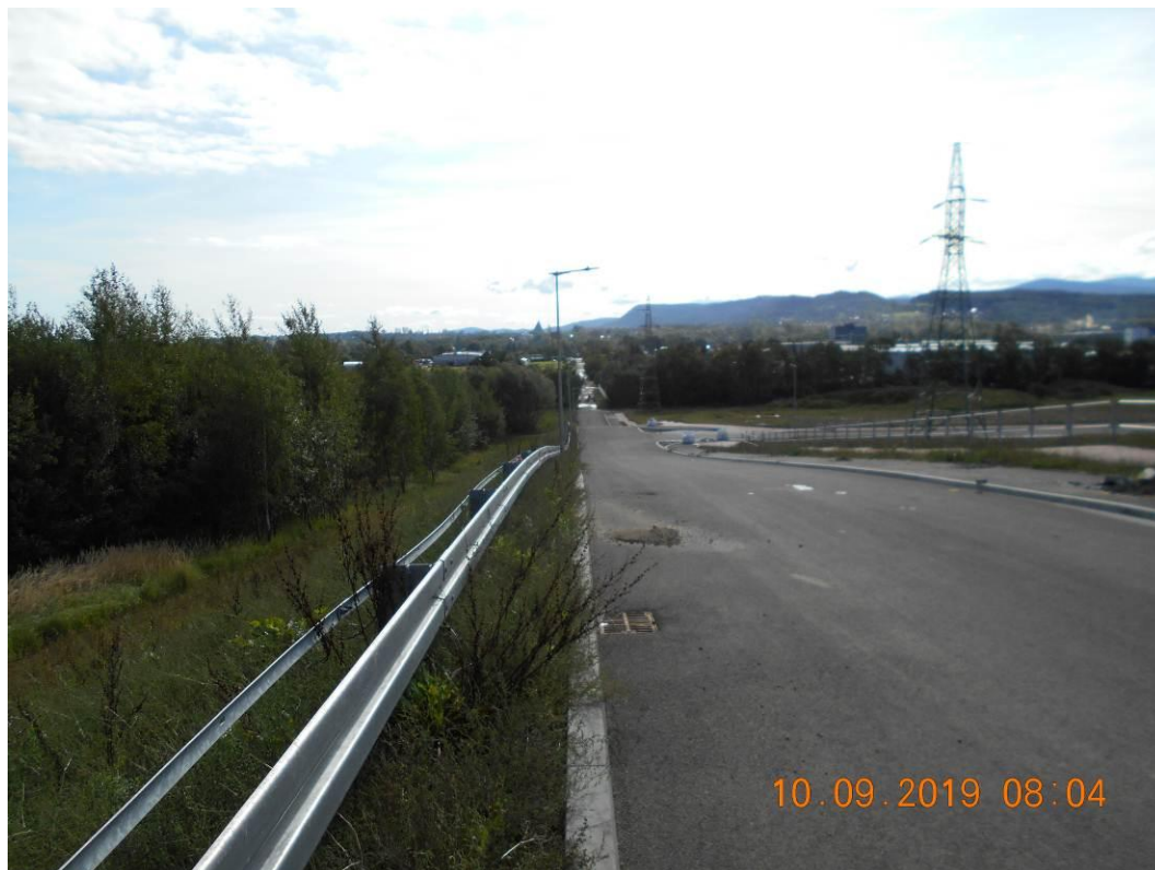
Fotogram nr 37- fragment ulicy Strefowej poniżej muru nr 1, brak przemieszczeń
