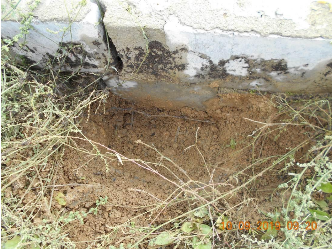
Fotogram nr 1 grunt spoisty w miejscu gdzie miała być wykonana zasypka filtracyjna, mur oporowy 1
