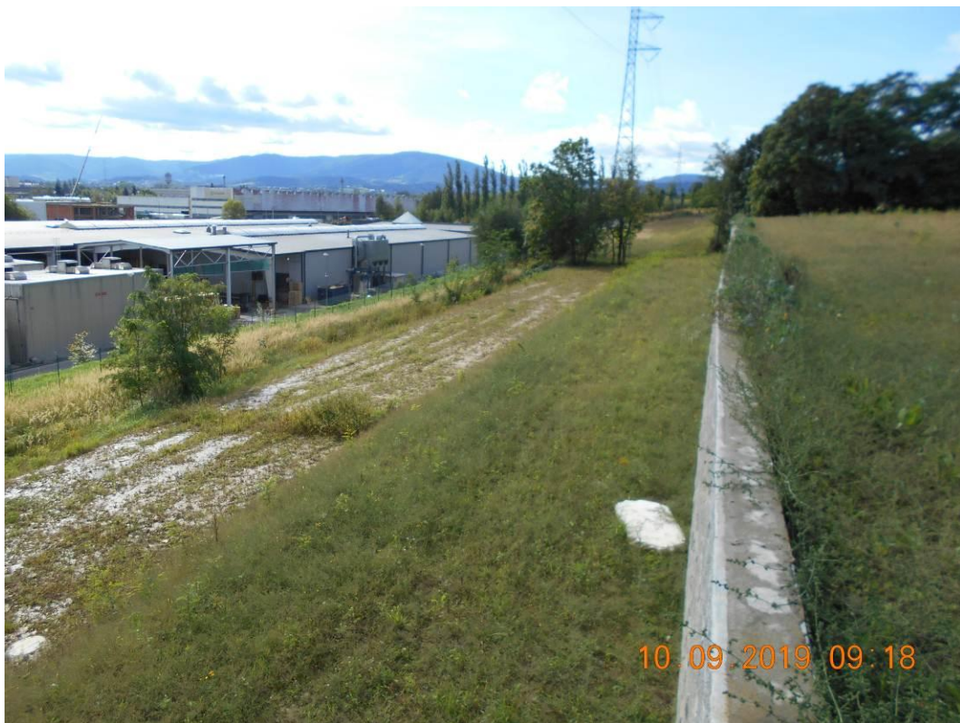
Fotogram nr 11 odkształcenie muru oporowego 1- część wysunięta najbardziej na wschód
