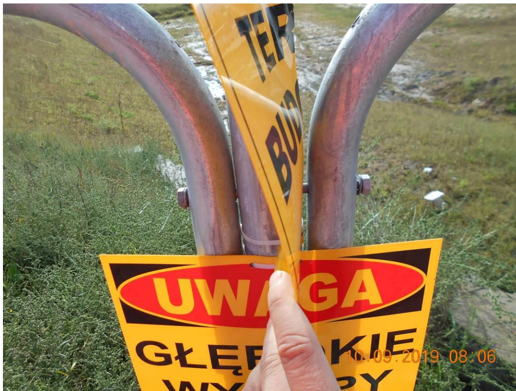
Fotogram nr 31- widoczny luz pod podkładkami łączącymi poszczególne przęsła balustrady.
