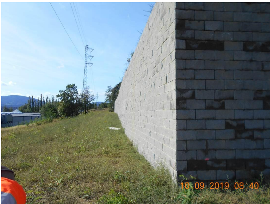
Fotogram nr 15 odkształcenie muru oporowego 1- część wysunięta najbardziej na wschód
