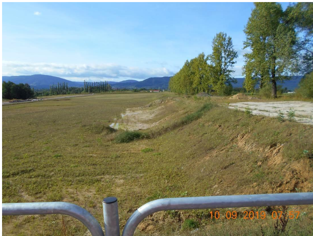
Fotogram nr 33- osunięcie skarpy przy ulicy Biała droga
