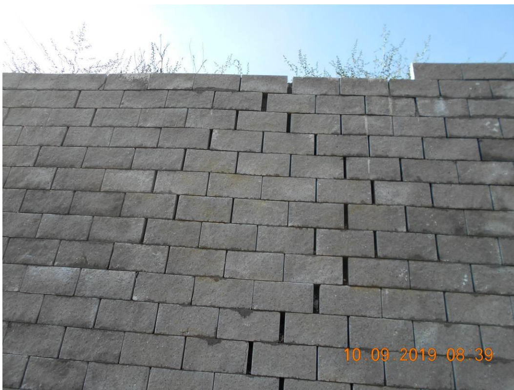
Fotogram nr 43 mur oporowy nr 1, widoczna deformacja w części najbardziej wysuniętej na wschód
