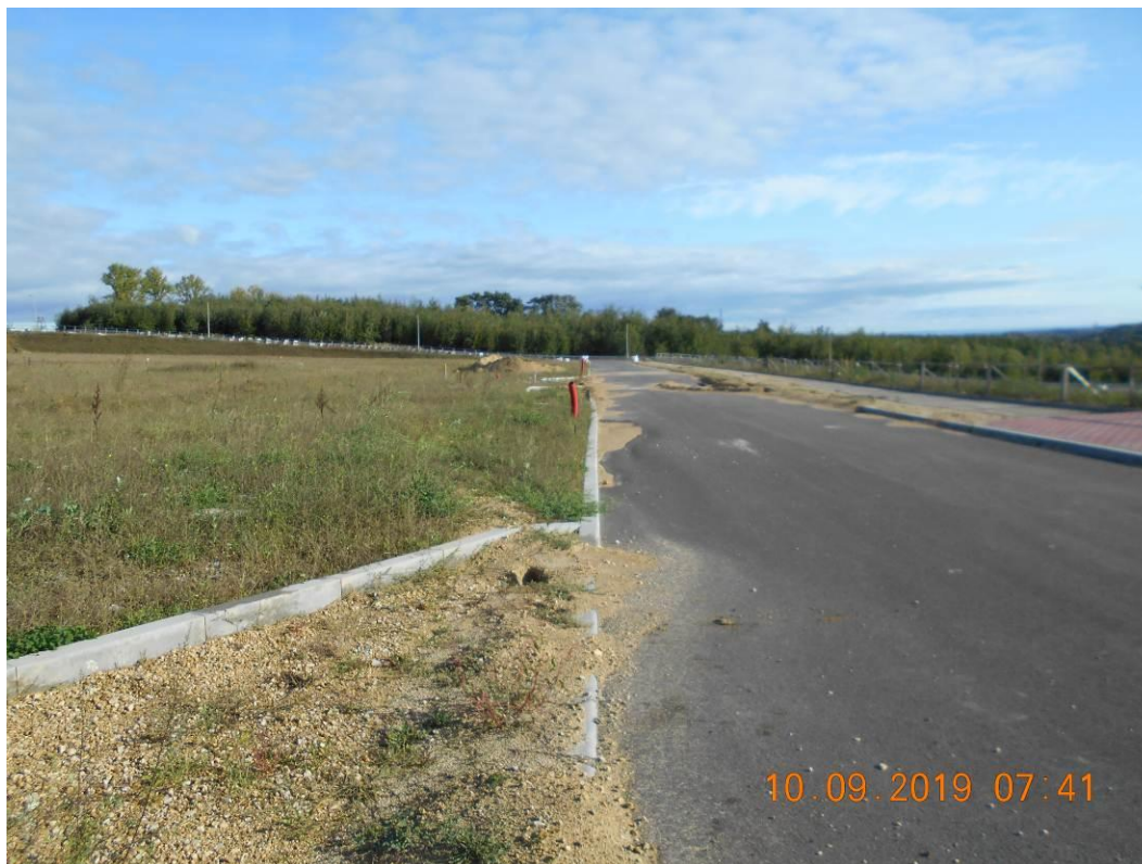
Fotogram nr 27 Nowo projektowana ulica łącząca ulicę Strefową z Przemysłową- widok na północ nad murem oporowym, widoczne przemieszczenie
