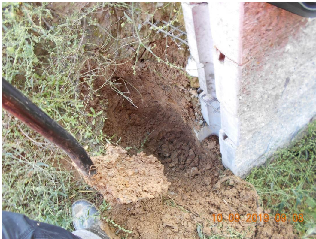
Fotogram nr 4 grunt spoisty w miejscu gdzie miała być wykonana zasypka filtracyjna oraz ze względu na szerokość widoczny fragment „zasypki” mur oporowy 1
