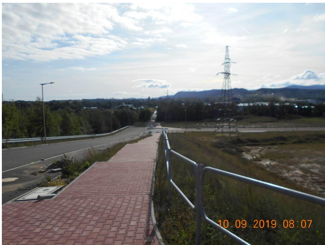
Fotogram nr 32- widoczne przemieszczenie balustrady zgodnie ze spadkiem skarpy w kierunku południowym, przemieszczenie jest tym większe im większa jest wysokość skarpy.
