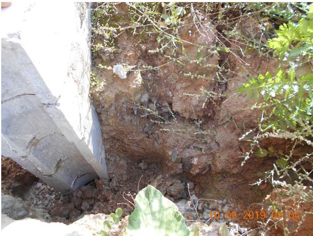
Fotogram nr 2 grunt spoisty w miejscu gdzie miała być wykonana zasypka filtracyjna, mur oporowy 2
