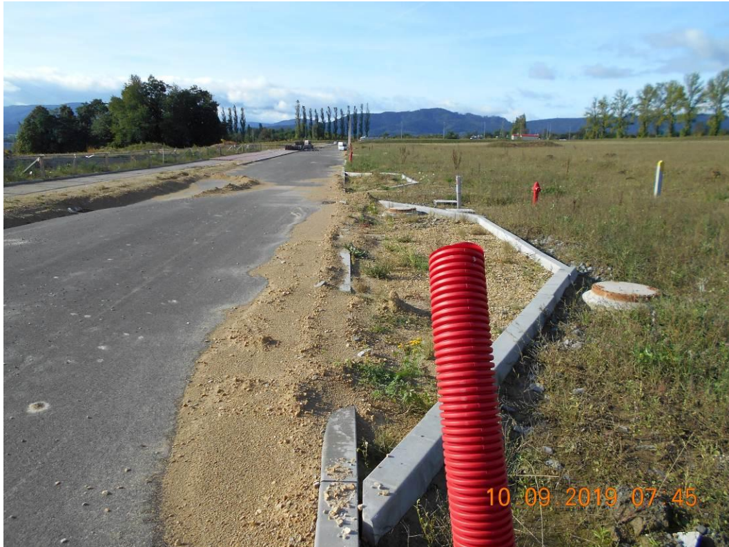
Fotogram nr 24 Nowo projektowana ulica łącząca ulicę Strefową z Przemysłową- widok na południe nad murem oporowym, widoczne przemieszczenie
