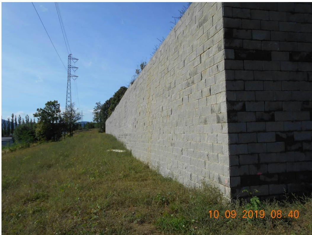
Fotogram nr 14 odkształcenie muru oporowego 1- część wysunięta najbardziej na wschód
