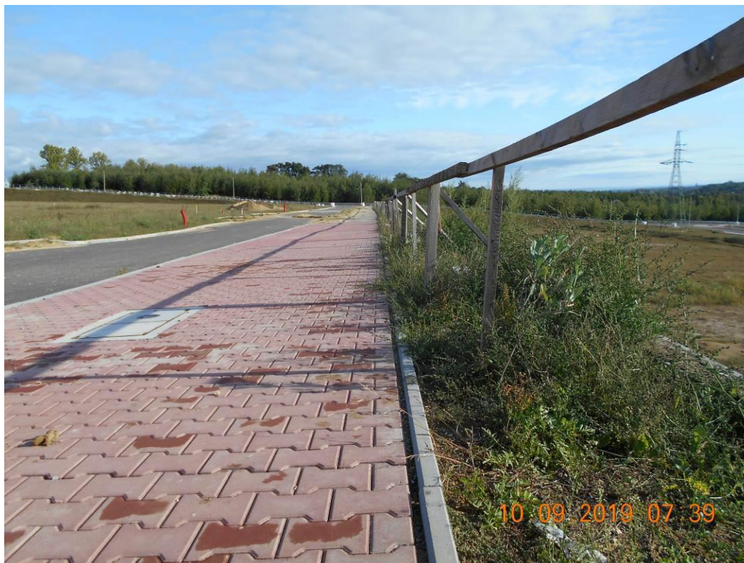
Fotogram nr 26 Nowo projektowana ulica łącząca ulicę Strefową z Przemysłową- widok na północ nad murem oporowym, widoczne przemieszczenie
