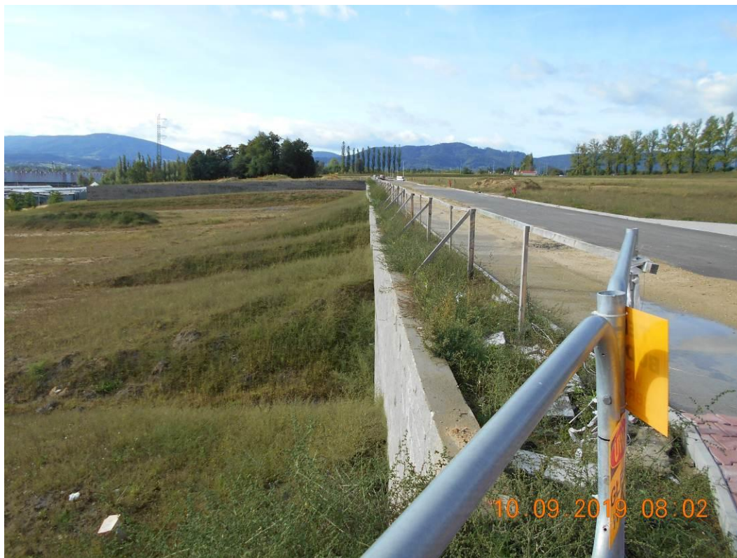
Fotogram nr 28 Mur oporowy 1, część wysunięta najbardziej na zachód, widoczne przemieszczenia
